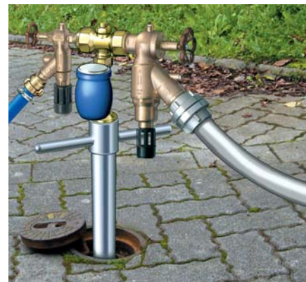
Anwendungsbeispiel einer fachgerecht abgesicherten Wasserverteilung an einem Standrohr für Unterflurhydranten.
