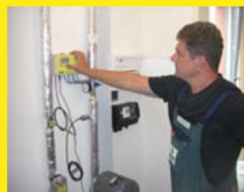
Programmierung der KHS-Mini Systemsteuerung
