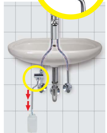
Probenahme mittels KEMPER Probenahmeventil mit integriertem Rückflussverhinderer unter einem Waschtisch. Rückfließen oder Überströmen von PWC nach PWH ist ausgeschlossen.
