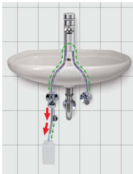
Probenahme am Eckventil PWH. Bei einem technischen Mangel in der Armatur kann es zum Überströmen von PWC in die Probe für PWH kommen.
